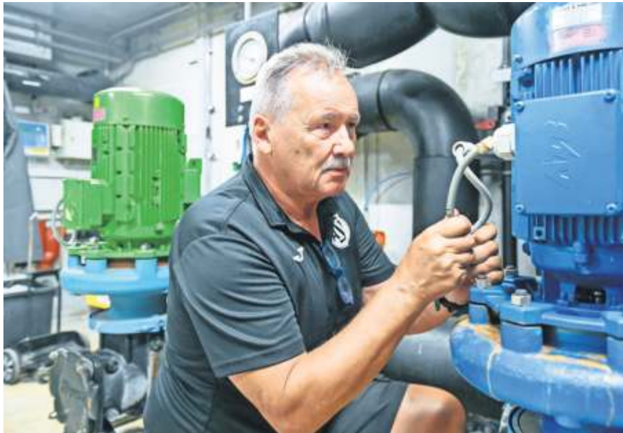
Rund 600 Stunden im Jahr verbringt Zenzs zwischen Heizkessel und Pumpen.
